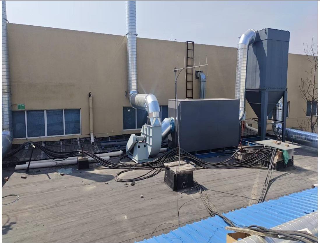
袋式除尘器+两级活性炭（石蜡融化及灌注、焊接工序、浸漆、烘干工序）
