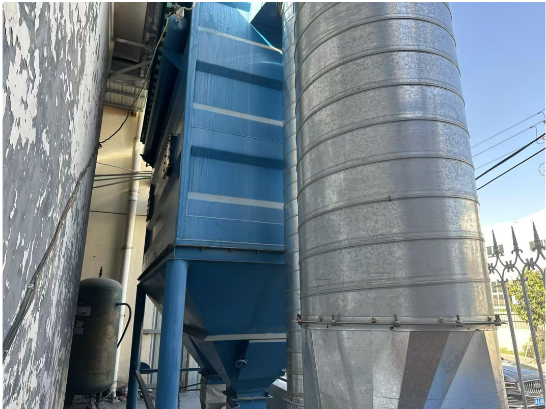
袋式除尘器（喷金工序）
