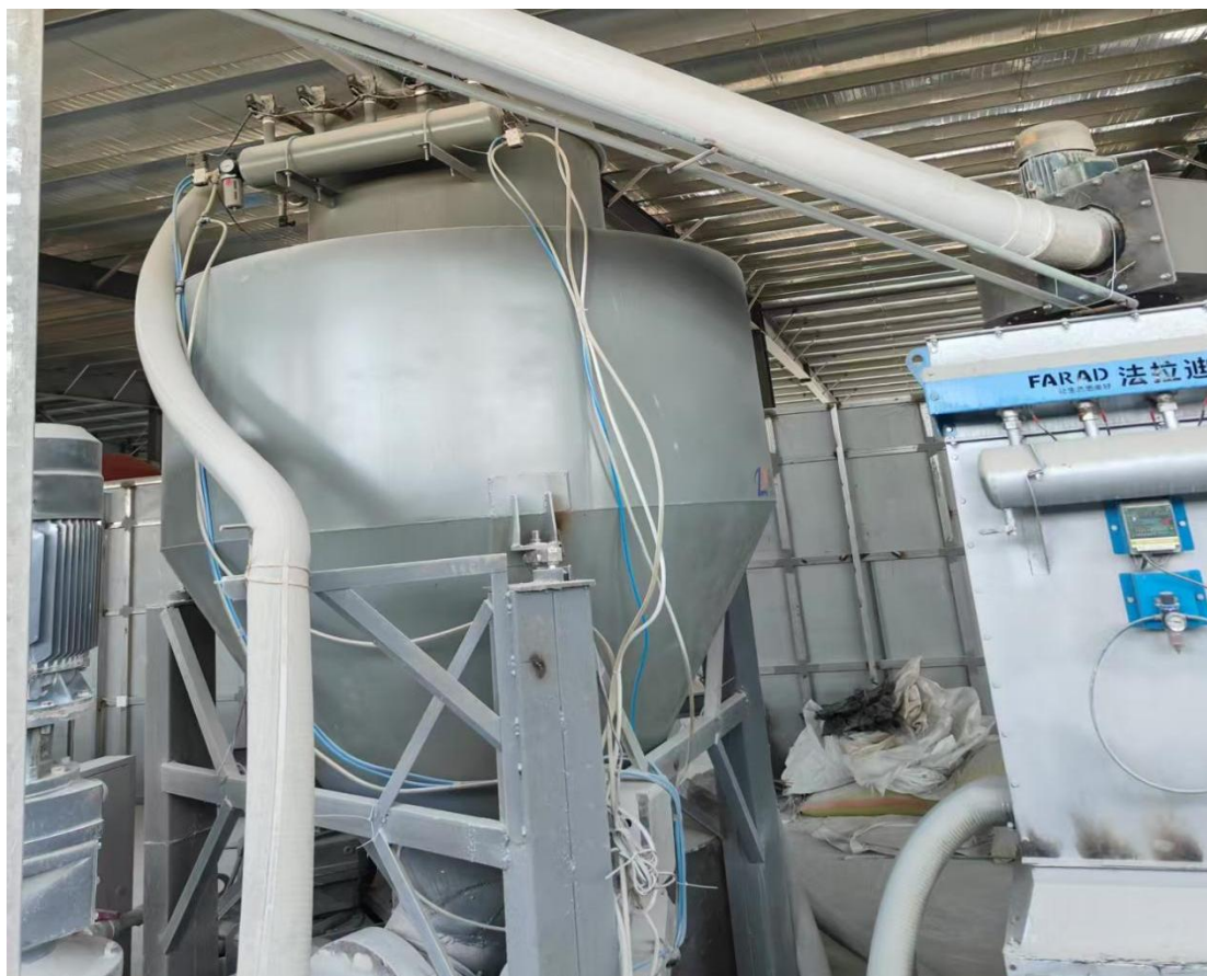
涉废气设备均安装集气罩收集
