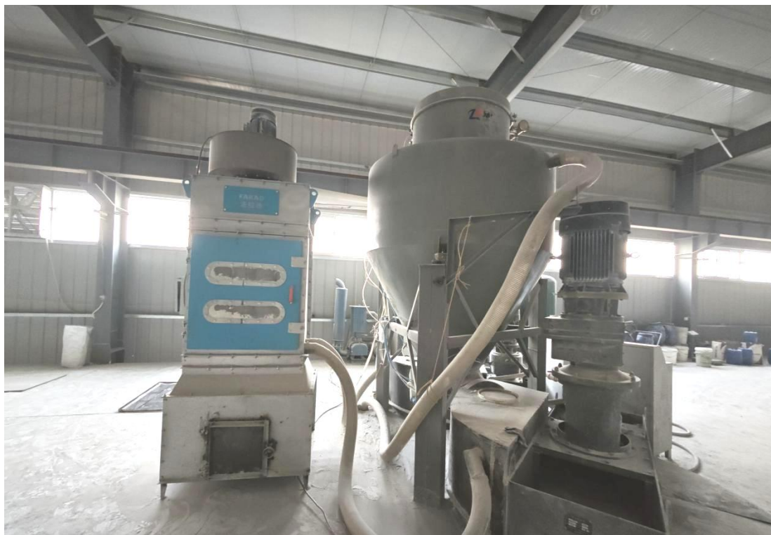
本项目废气处理设施
