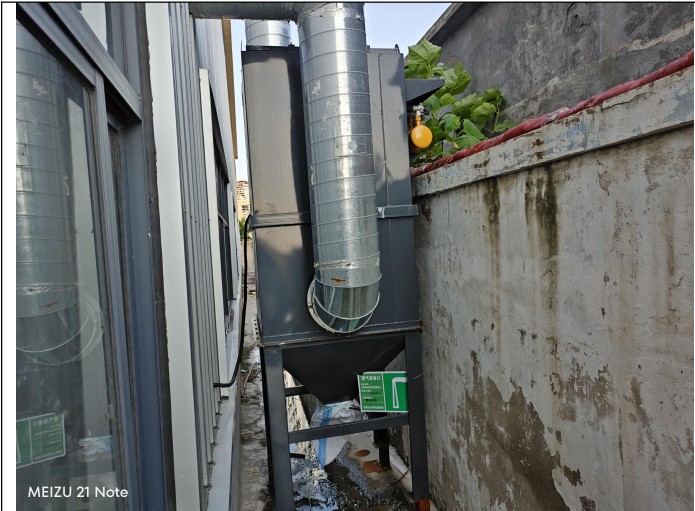
除尘器+排气筒
